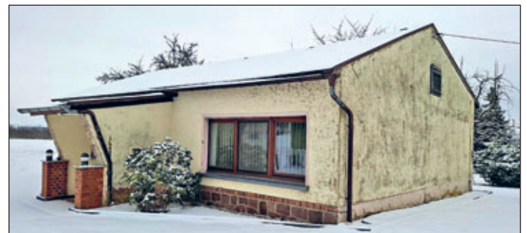
Das Kulturhaus in Höfchen bekommt dankte des Regionalbudgets 2026 eine neue Heizung und einen frischen Fassadenanstrich. (Foto: Gemeinde Kriebstein)
